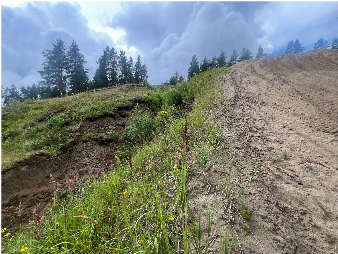
Radan reunan vesiuria tasoitetaan ja ratalinjaa viedään kauemmaksi ojista esim. penkan avulla.
