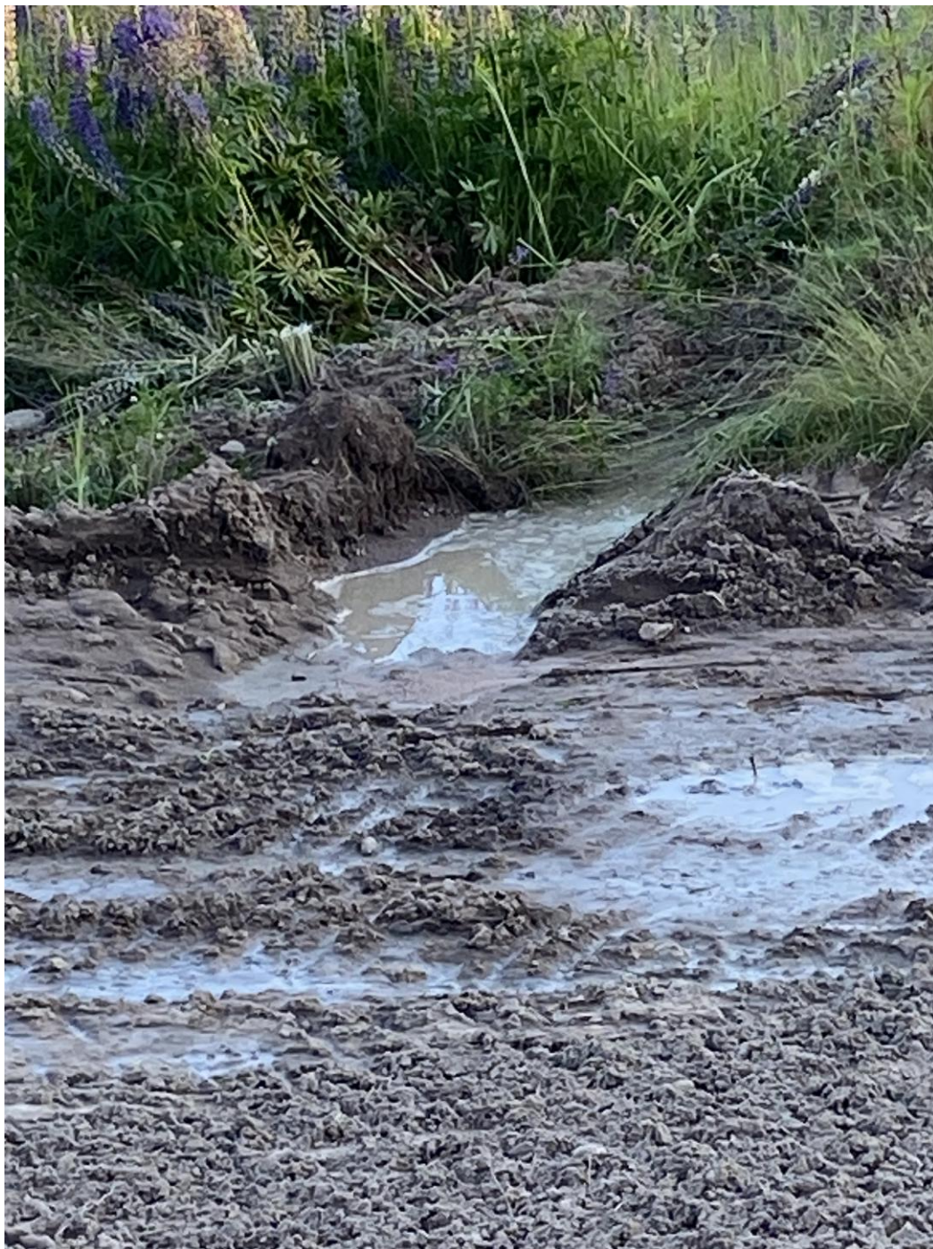
Kuva 3 ojitus liian lähellä rataa, korjaus suoritettu kuvan ottamisen jälkeen.
